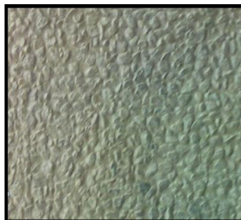
GWB 8 2 frakcje kruszywa Większe „upakowanie” grysów. Tekstura wykonana szczotką stosowaną na budowie
