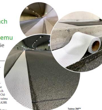
Taśma 3M™ STAMARK™ A380iES w tunelu drogi S2 w Warszawie
