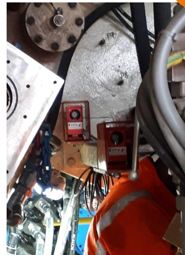
2 niewspółosiowe pryzmaty zamontowane na tarczy TBM, z przesunięciem odległości
