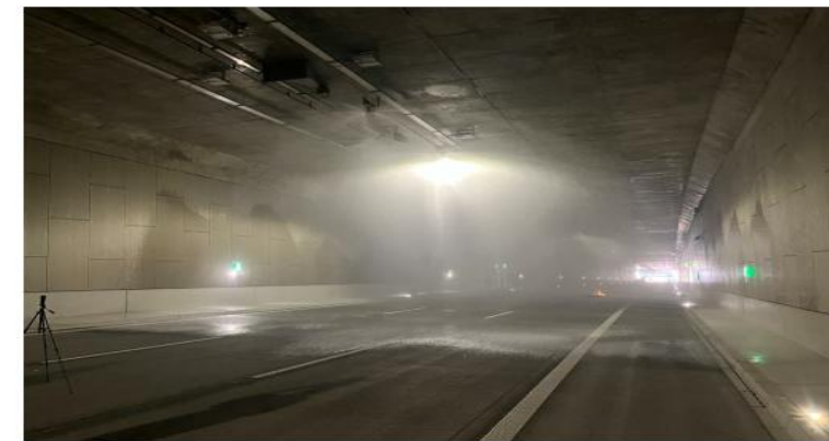
Fot. 12 Widok momentu wyzwolenia sekcji instalacji zraszaczowej w strefie detekcji pożaru
