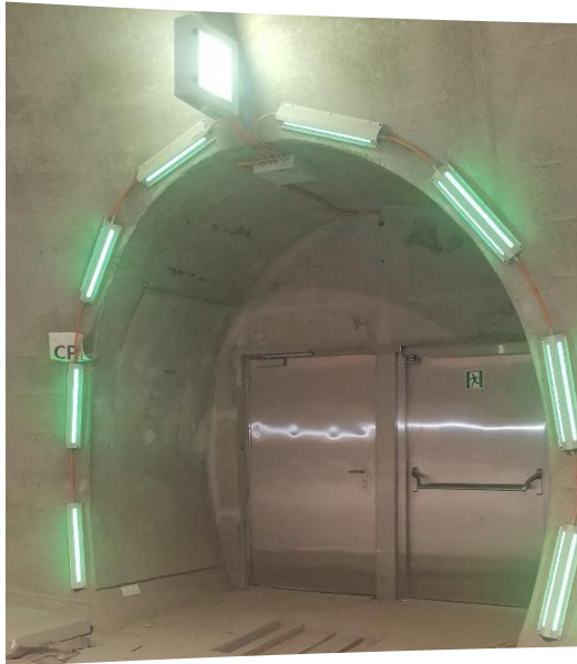
Przejścia ewakuacyjne dla użytkowników tunelu
