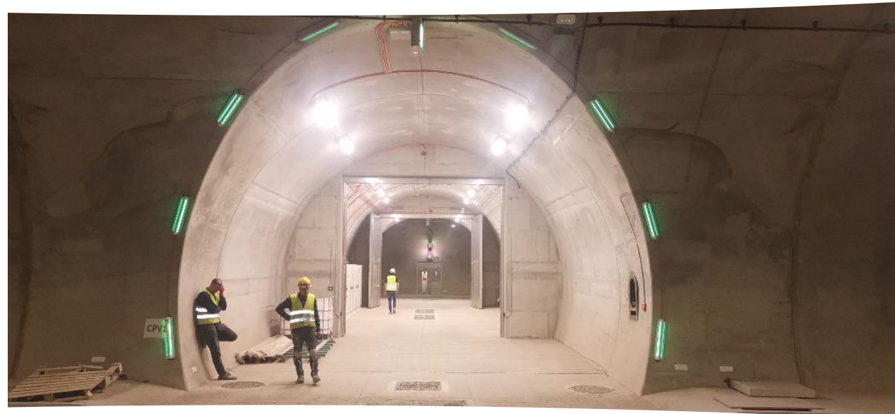
Przejazd awaryjny w połowie tunelu dla lekkich samochodów ratowniczo gaśniczych i ratowniczych
