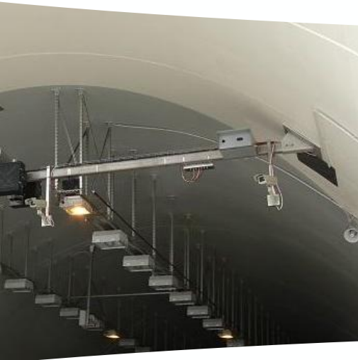
Kamery w nawach tunelu
