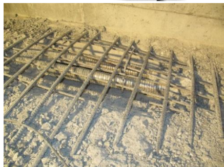
Zarysowanie w miejscu zakrzywienia kabla
