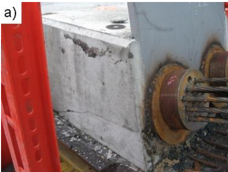
Zarysowanie w obrębie głowicy kotwiącej
