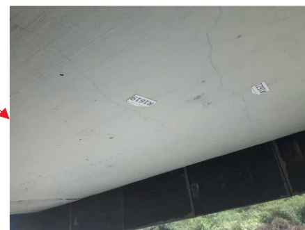
Zarysowanie płyt w obszarze stopniowej mobilizacji sprężenia
