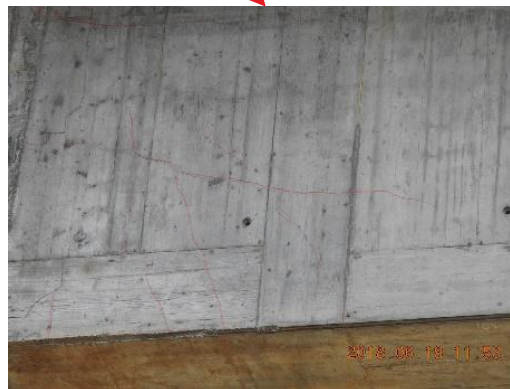
Zarysowanie w miejscu styku segmentów
