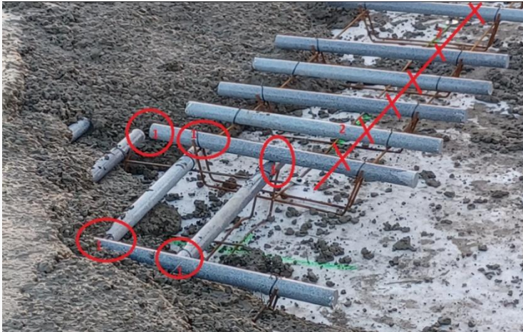
Skrzyżowanie dylatacji – dyble ułożone na dyblach (!!!)
