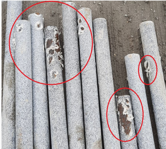
Uszkodzone dyble powinny być wymienione na nowe
