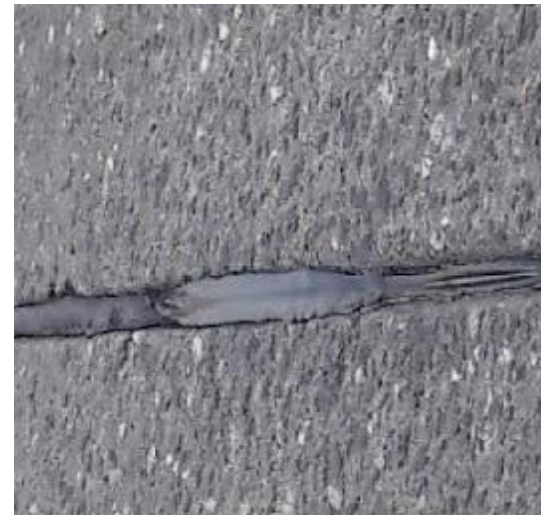
Niewłaściwe wypełnienie masami zalewowymi
