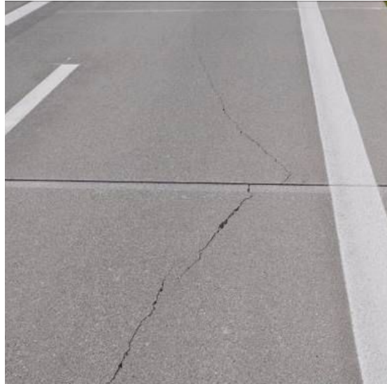
Pęknięcia płyt wskutek zanieczyszczeń
