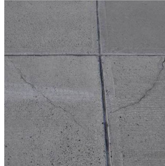
Uszkodzenia krawędzi i narożników
