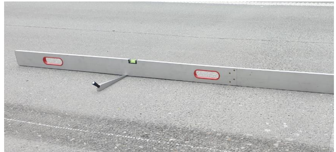
Nierówność na płycie betonowej
