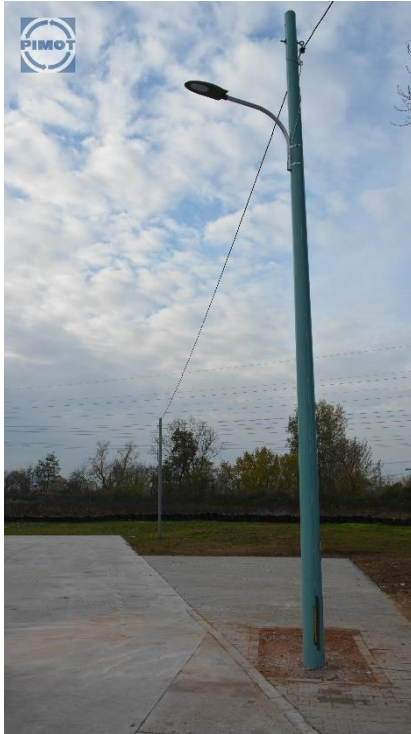
Słup energetyczno- teletechniczny sieci skojarzonej
