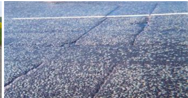
Spękania od przekopów
