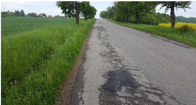
Spękania od poszerzeń
