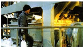
1. Dozowanie ręczne do mieszalnika wytwórni mieszanek
