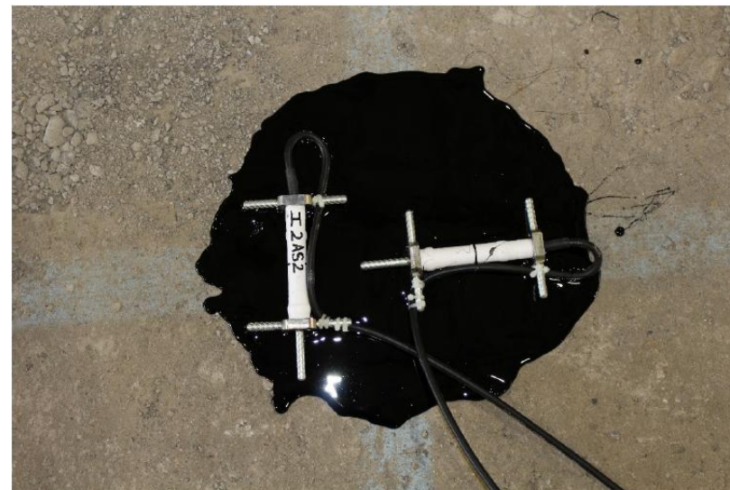
czujniki pomiaru odkształceń poziomych
