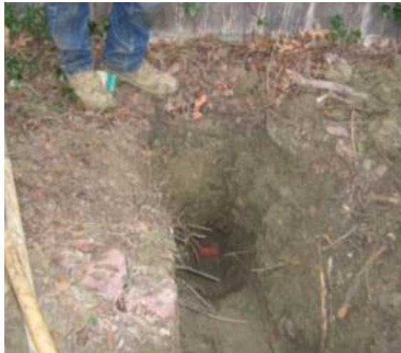
Nieprawidłowa instalacja (połączenie)
