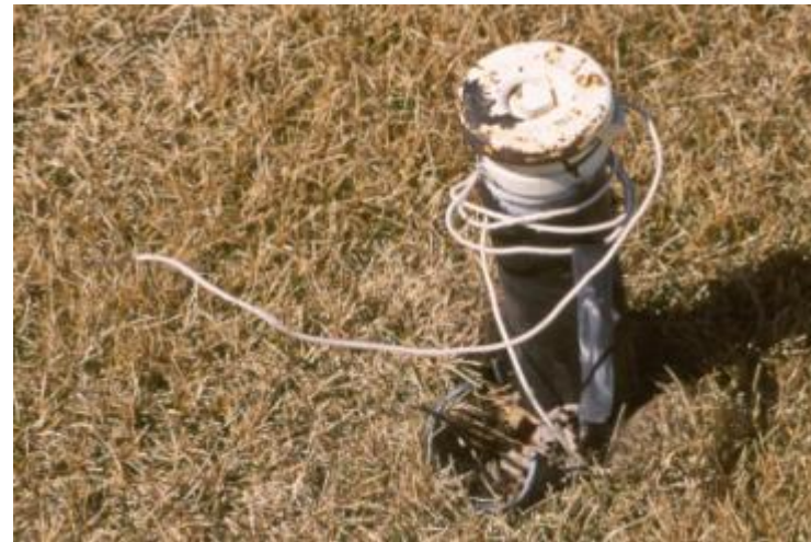
Niebezpieczne wyprowadzenie linki nad grunt
